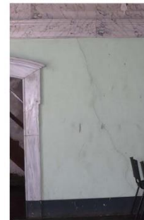
foto 28 – trinca inclinada interior da igreja
