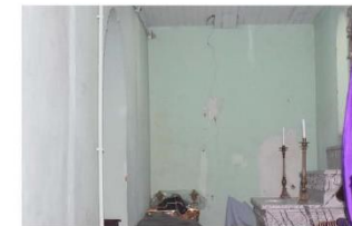
foto 29 – trinca vertical interior da igreja
