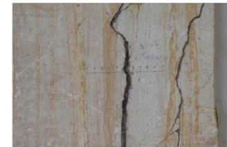
foto 27 – trinca com monitoramento - parede interna da torre
